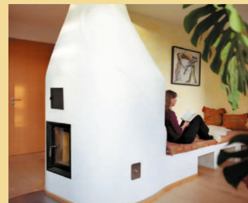
Der Kachelofen wärmt auch, wenn das Feuer nicht brennt. In seinen Wänden verbirgt sich eine Flächenheizung.
